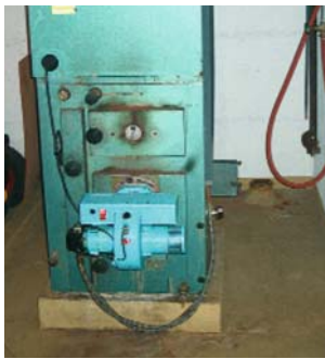
Diese Heizungsanlage gilt es demnächst zu ersetzen.
