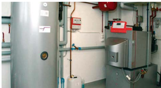
Eine effiziente Wärmeerzeugung ist mit einem modernen Ölheizkessel garantiert.
